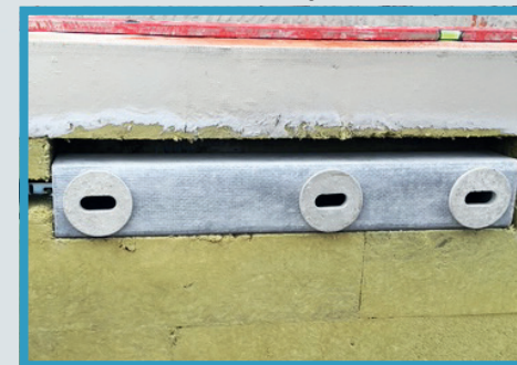
▼ Speciel redekasse monteret på facaden med facadebatts omkring © Rune T. Olsen
